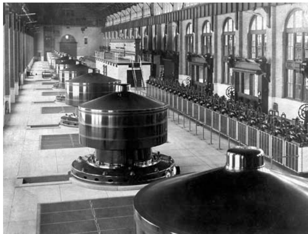
Niagara Falls Power Co. (1895). Sala de turbinas. Buffalo, Estados Unidos.
