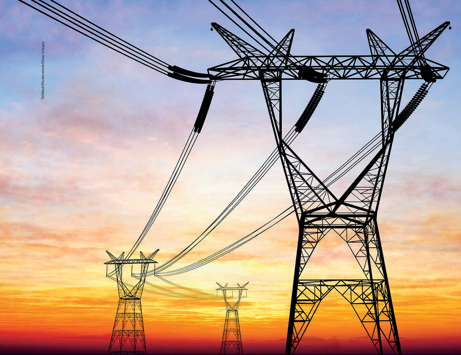
Linhas de transmissão de alta-tensão.
