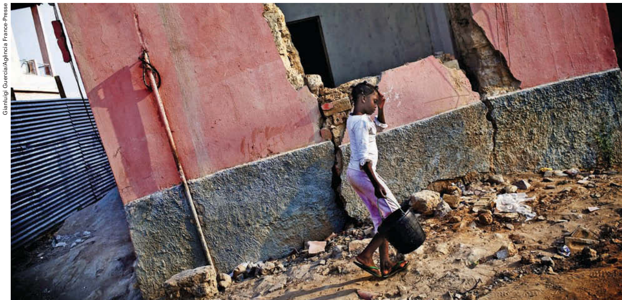
Garota angolana carrega um balde de água em frente à casa destruída em rua de Kuito, provincial de Bie, região central de Angola. O país passou por um período de 27 anos em guerra civil, conflito que deixou marcas na estrutura das construções de diversas cidades. Foto de 2008.
