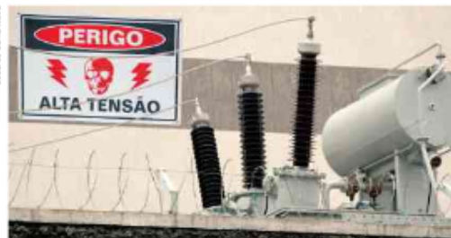
Placas como a da fotografia advertem quanto aos riscos de choques elétricos.
