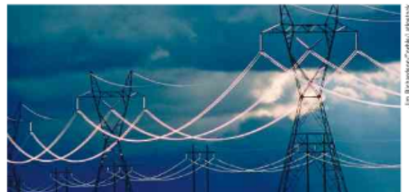
A fotografia mostra o efeito corona ocorrendo em linhas de transmissão com sobrecarga.
