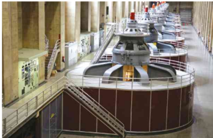
Nessa fotografia vê-se um conjunto de geradores em uma usina produtora de energia elétrica. Eles convertem a energia mecânica disponível em seus eixos em energia elétrica. O processo de conversão é fundamentado no fenômeno da indução eletromagnética.
