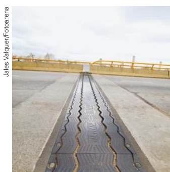
// Fendas na estrutura de um viaduto.
