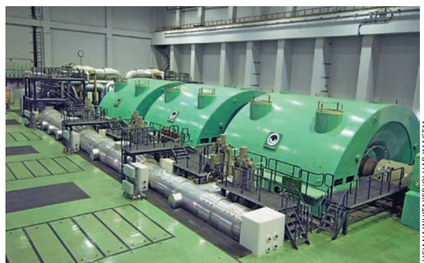
Turbo-geradores movidos a vapor. (Usina Nuclear Angra 2, RJ, 2007.)
