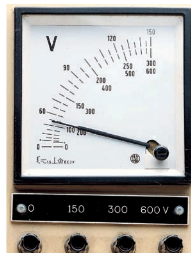
Voltímetro em funcionamento.
