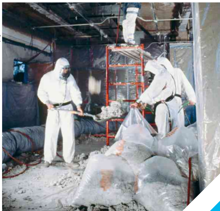
Equipe removendo amianto de um edifício comercial nos Estados Unidos da América em 1988.
