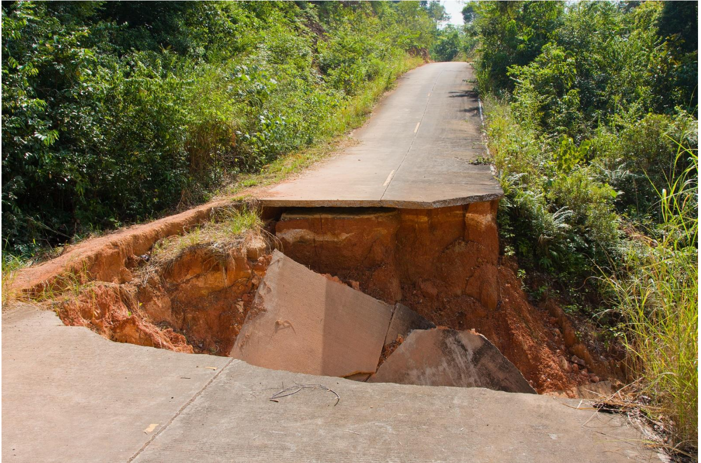
Fig. 66: Erosão pluvial causando danos ao pavimento de uma rua.
