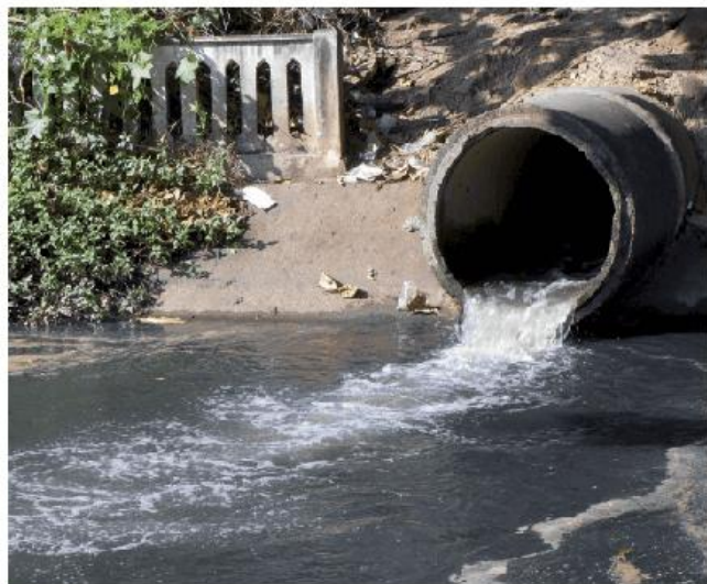
Fig. 19 O despejo do esgoto sem tratamento nos cursos-d'água representa um grande aporte de nutrientes para o ambiente aquático, o que contribui para a ocorrência de eutrofização.
