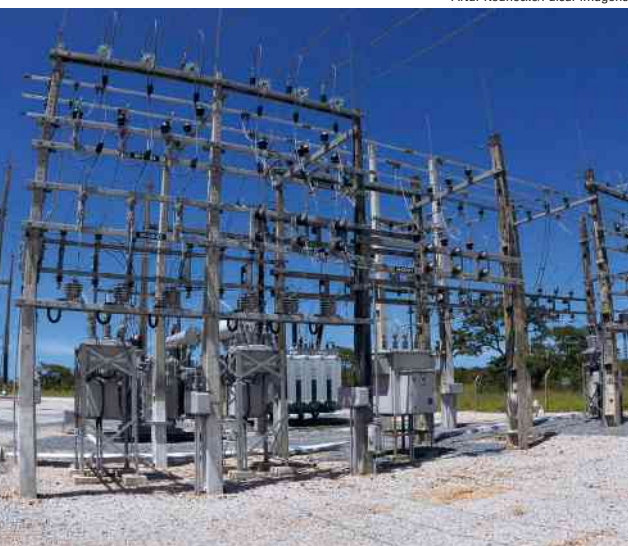
Figura 7.14 Subestação de energia elétrica na Chapada dos Guimarães (MT), em 2015.
