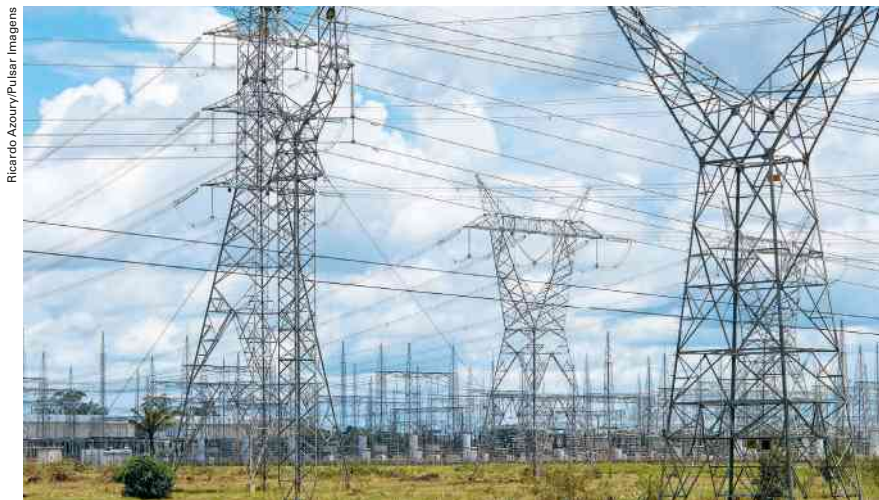
Figura 2.15 Linhas de transmissão de energia elétrica da Usina Hidrelétrica Santo Antônio, em Porto Velho (RO), 2016.
