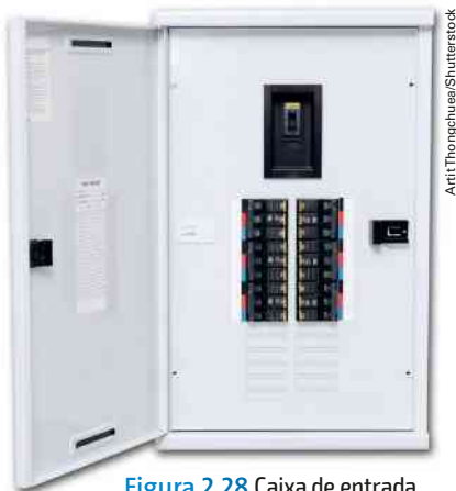
Figura 2.28 Caixa de entrada de energia elétrica em uma residência.
