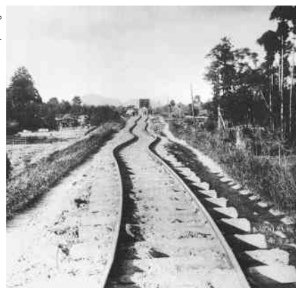
Figura 7.11 Trilhos retorcidos por causa da dilatação.
