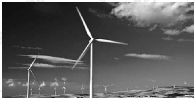
Torres eólicas na Serra das Vacas, PE.
