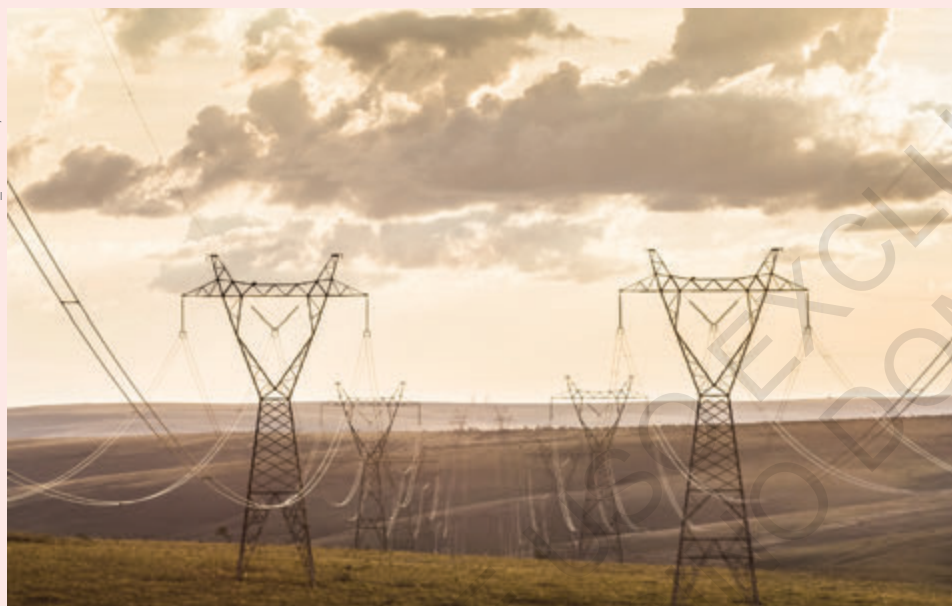
Linhas de transmissão de alta tensão ao pôr do sol.
