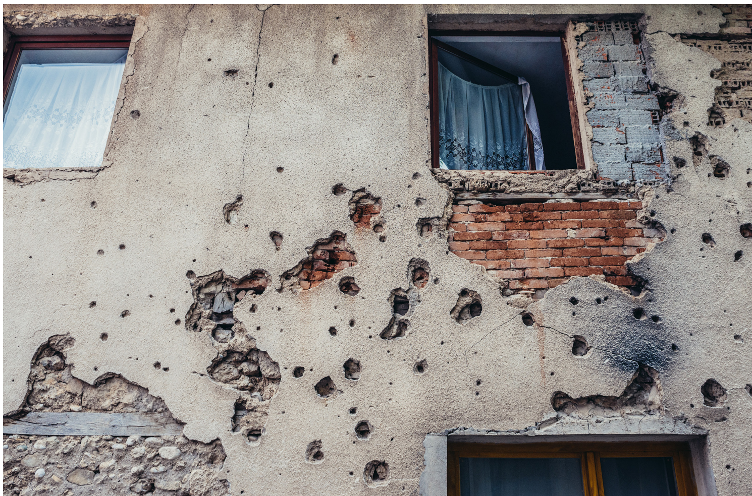
Construção com buracos de bala do período da Guerra da Bósnia em Mostar, Bósnia-Herzegovina - Fonte: Fotokon/stock.adobe.com
