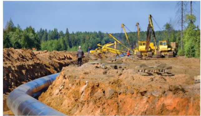
Fig. 1 Os maquinários modernos modificaram a relação entre o homem e o meio, uma vez que permitiram o aumento do ritmo de exploração dos recursos naturais. Na imagem, construção de um gasoduto na Rússia.
