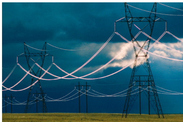
A fotografia mostra o efeito corona ocorrendo em linhas de transmissão com sobrecarga.
