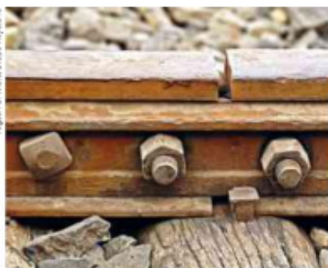
Fotografia mostrando espaço entre trilhos.
