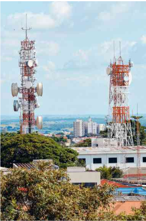
Figura 10.27 Torres de telefonia móvel. Campinas (SP), 2015.
