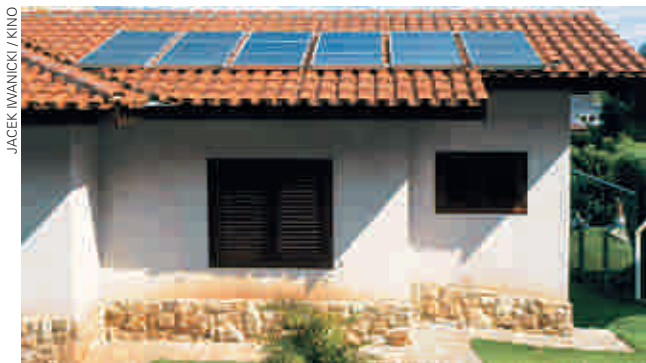
Painéis de aquecimento solar no telhado de uma casa.
