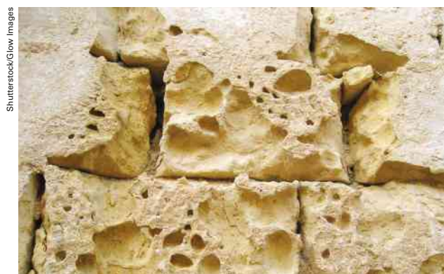
Figura 20.1 Parede de pedra corroída pela chuva ácida.
