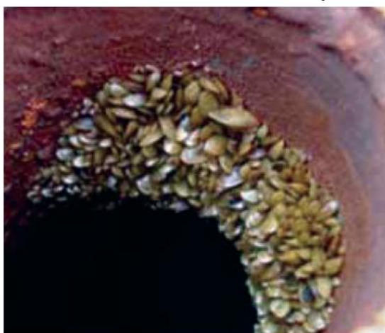
Colônia de mexilhão dourado em tubulação
