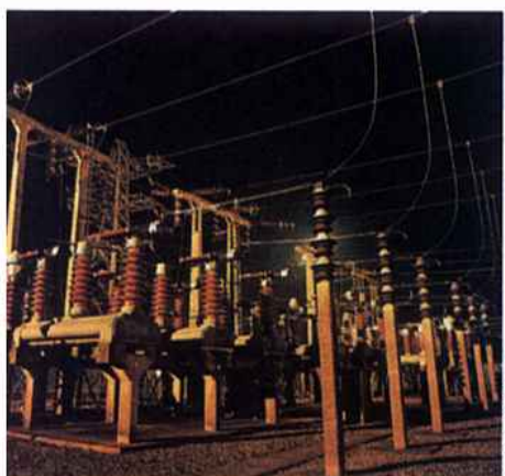
Na foto, vemos um tipo moderno de transformadores, montados sobre base de concreto, para evitar "fugas" de corrente elétrica para a Terra.
