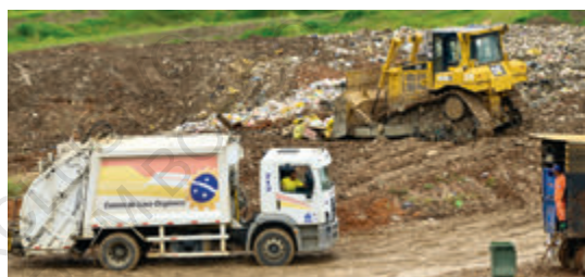
Aterro sanitário inaugurado em 2017, entre Ceilândia e Samambaia, para a gestão dos resíduos sólidos no DF.
