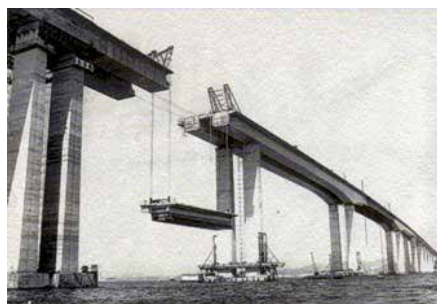
A construção da ponte Rio-Niterói (RJ), 1974, foi uma das obras que mais marcaram o período do milagre econômico.
