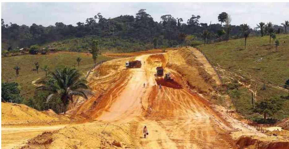
Figura 28. Obras em trecho da Rodovia Transamazônica em Altamira (PA), 2011. O projeto da rodovia, ao possibilitar a ligação entre o Nordeste e a Amazônia, tinha como objetivo facilitar o processo migratório, com saída de trabalhadores nordestinos, a fim de minimizar as pressões por reforma agrária na Região Nordeste.
